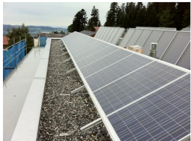
varmeco-Solarkollektoren (rechts) und PV-Anlage (links) auf dem Flachdach des Wohngebäudes.
