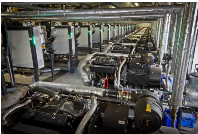
Kaskadenkonfiguration der Spanner Holz-Kraft-Anlage
