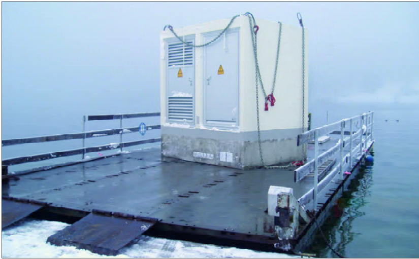
Um die elektrische Leistung in St. Bartholomä bereitzustellen, wurde dort eine neue Transformatorstation aufgestellt
