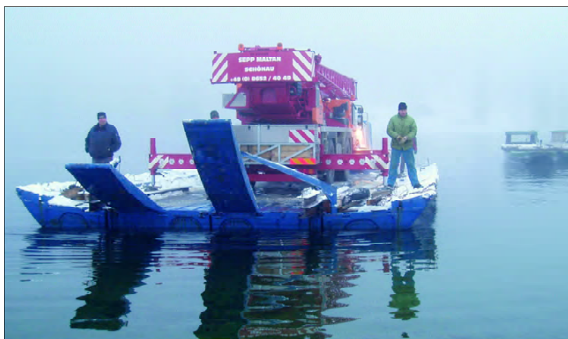
Nicht nur die Transformatorstation, sondern auch ein Lkw und ein Kran mussten auf die Halbinsel verschifft werden, ...
