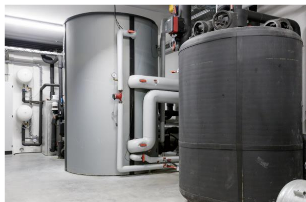
In der Technikzentrale stehen ein 5000-Liter-Wärmespeicher (hellgrau) und ein 2000 Liter fassender Kältespeicher (anthrazitfarben).
