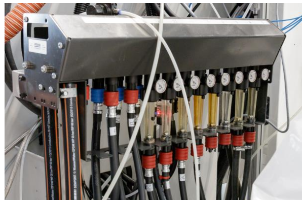
Das Kühlen des Öls und die Wärmeabfuhr von den Spritzgießwerkzeugen erfolgt mithilfe der zentralen Gebäudetechnik.
