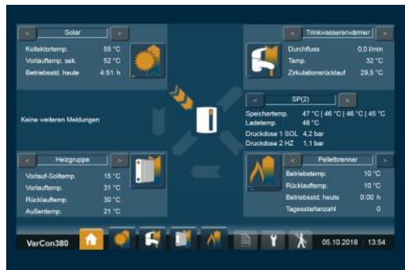
Relevante Anlagendaten und den Druck in Heizungs- und Solaranlage kann SHK-Profi Gaukler via Internet am PC ablesen.
