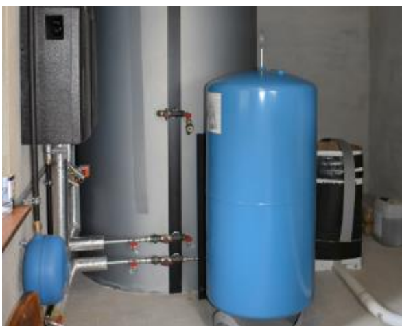
Im grauen varmeco-Schichtspeicher wird die Wärmeenergie auf verschiedenen Temperaturniveaus vorgehalten.
